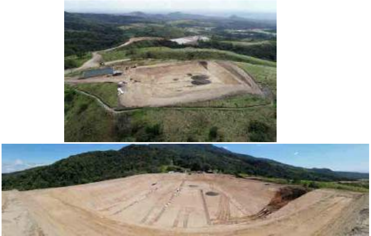
Figura 154. Laguna de almacenamiento.
