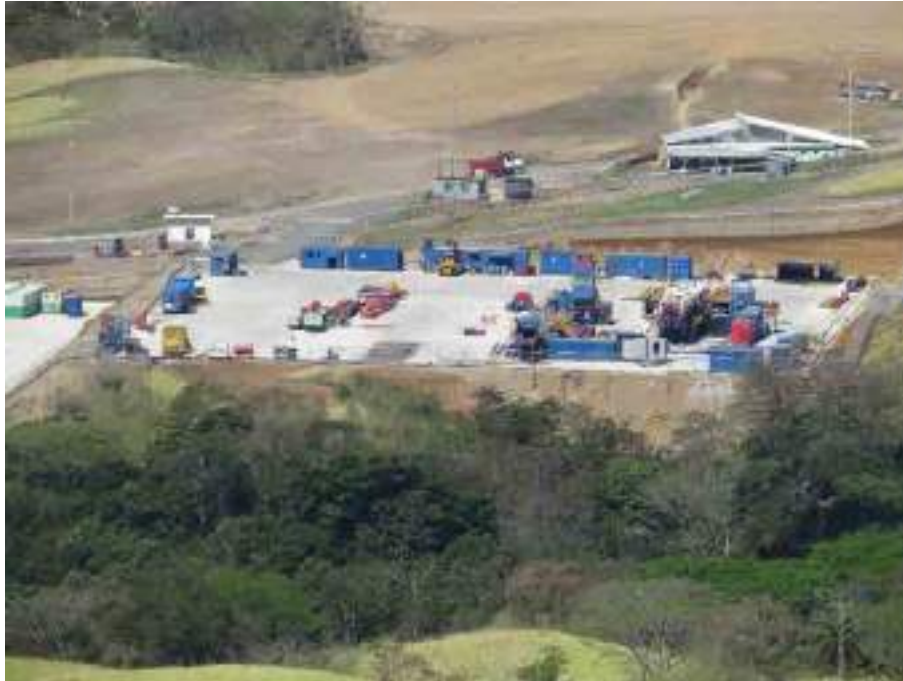
Máquina perforadora K-Pem almacenada en la Plazoleta PLB-08. Marzo 2021.
