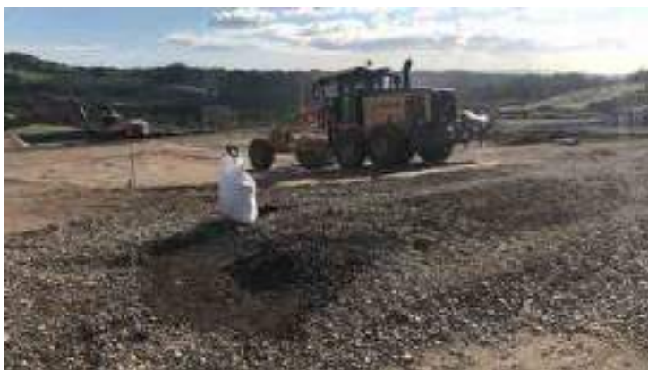
Figura 10. Detención de niveladora con fugas de aceite que generó derrame de 4 m 2 .
