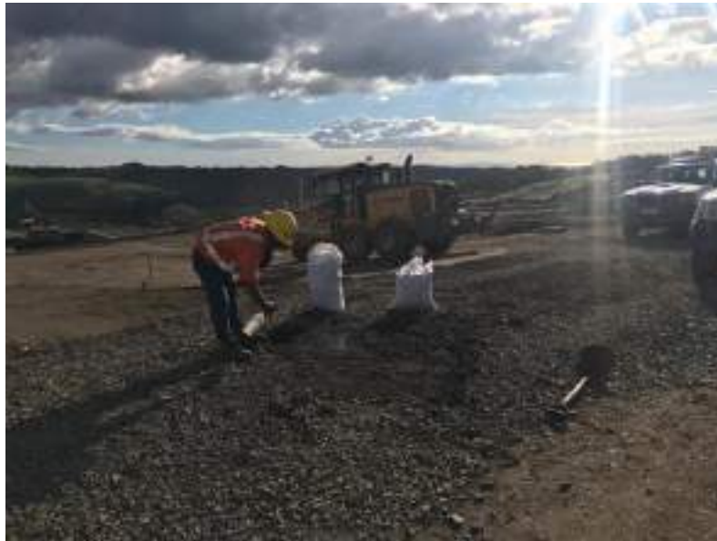
Figura 32. Atención derrames de hidrocarburos.
