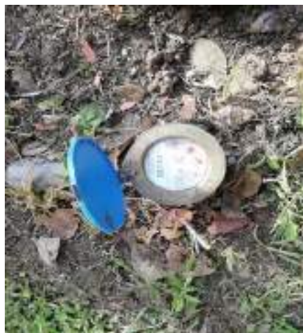
Figura 104. Medidor de consumo hídrico del campamento de Curubandé
