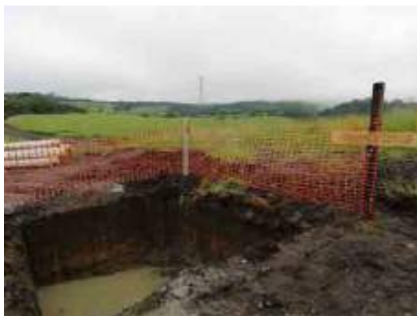
Figura 54. Sedimentador natural para lavado de concreto.
