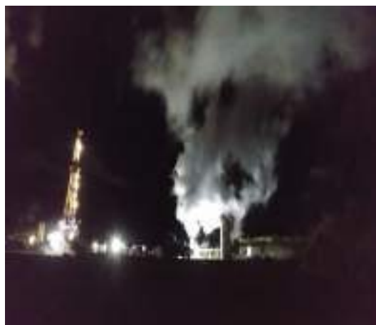
Figura 91. Luminarias en equipo de perforación N°2 en PLB-02.
